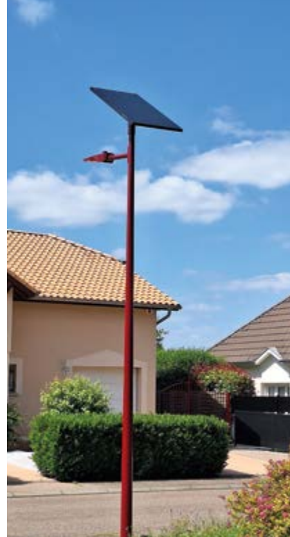
Les premiers éclairages autonomes ont été installés aux Hameaux du bois.
